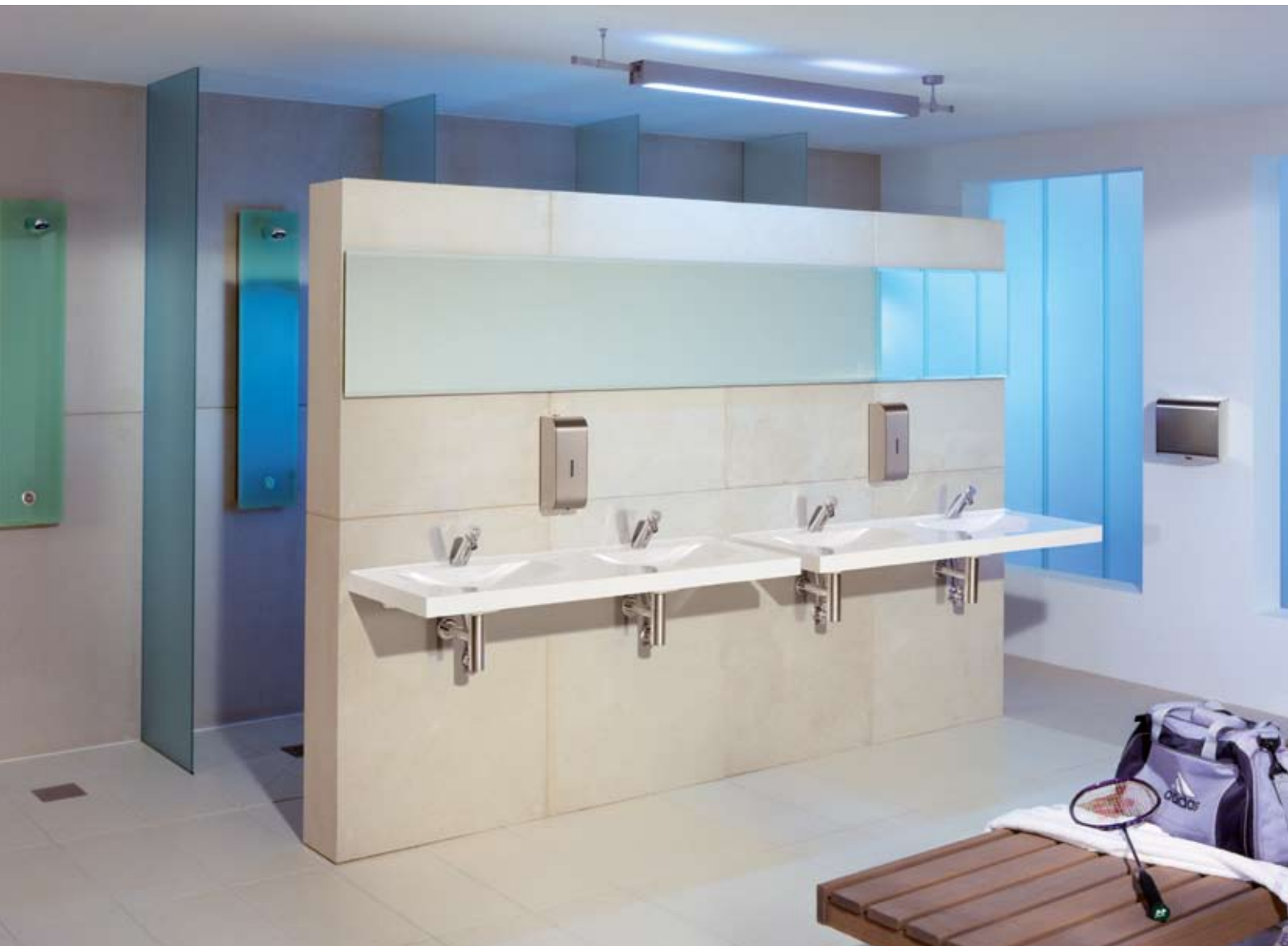
Installation sportive avec deux lavabos doubles RONDA avec mitigeurs à fermeture automatique AQUAMIX-S, série accessoire XINOX®.
